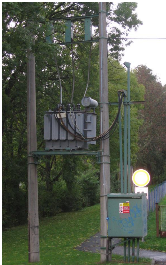
Trafostanice nahrazena transformátorem.
